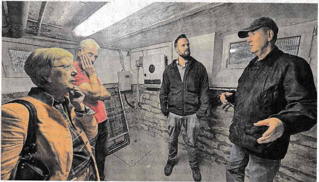
Die im Keller angebrachten Komponenten seiner PV-Anlage zeigt Erwin Denninghaus (rechts) seinen Besuchern, unter anderem dem Soester Klimabeauftragten Tim Scharschuch (Zweiter von rechts) und der stellvertretenden Bürgermeisterin Christiane Mackensen.
