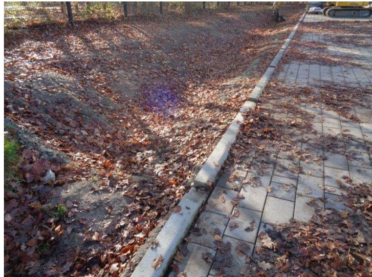
Muldenversickerung zur Aufnahme des Parkplatzwassers. Foto: Kreis Soest, Eva Lüning
